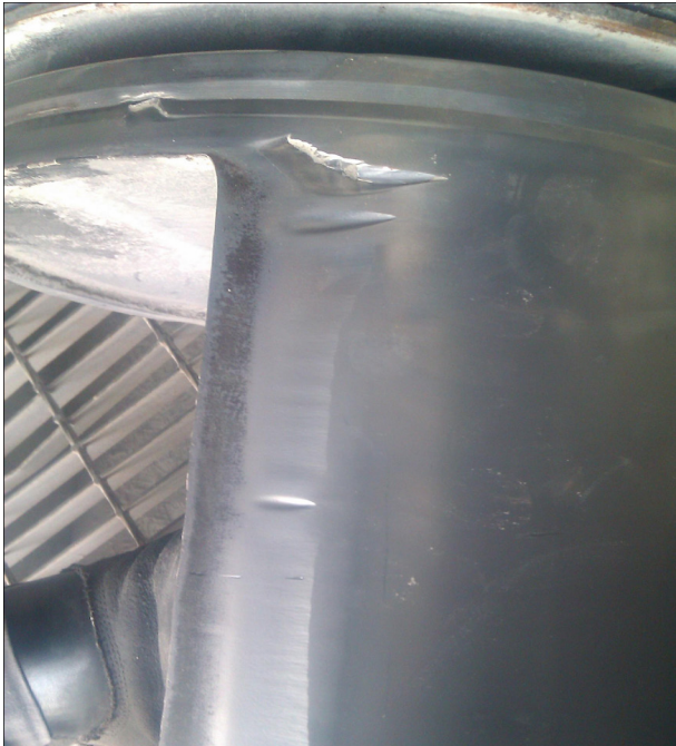
الشكل رقم 6 : خصائص التآكل لبوابات التحكم في التدفق
